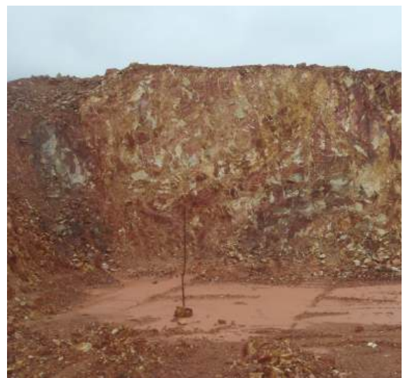
Tư vấn độc lập phân cấp đất đá thi công – Hồ Tân Trạch, Thừa Thiên Huế
